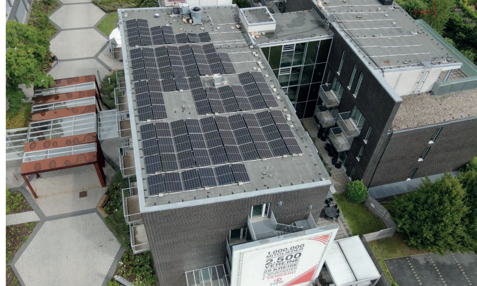
Die PV-Anlage auf dem Dach des SportHotels
